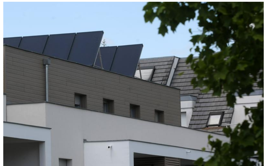
Sur le toit de l'immeuble, 400m 2 de panneaux solaires photovoltaïques. Ils peuvent produire 58 000 kW d'électricité par an. PHOTO DNA - LAURENT RÉA
